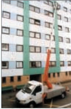
DL21T bei der Instandhaltung einer Fassade am 5. und 6. Stockwerk. Schnell und Sicher.
